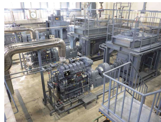
エンジン・ポンプ設備
