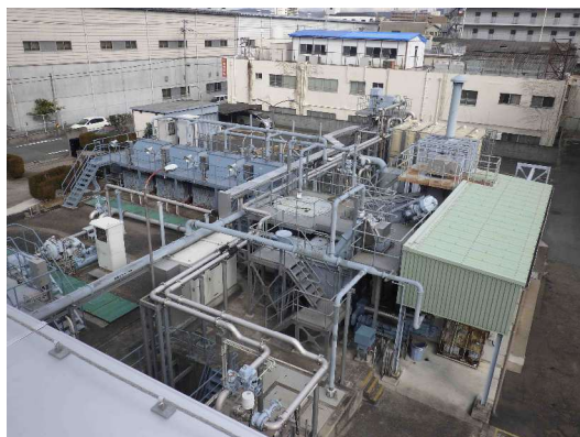
沈砂掻き揚げ設備
