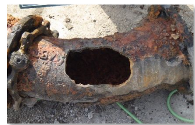
老朽化した水道管
