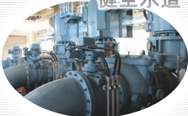
水走配水場 ポンプ施設
