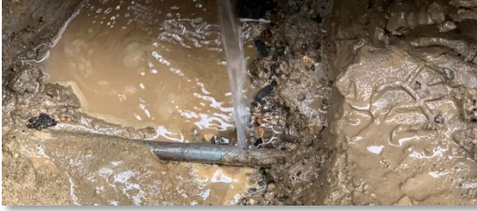
鉛製給水管からの漏水状況
