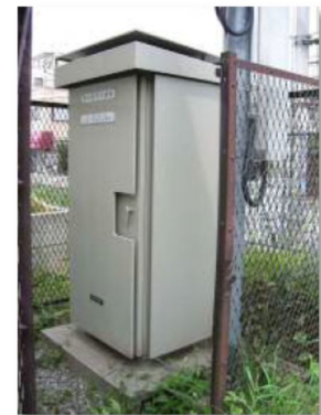
自動水質監視装置
