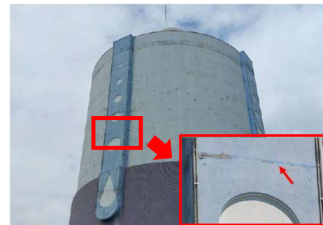
ひび割れの発生（外壁）
