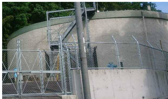
屋根（天井）の劣化
