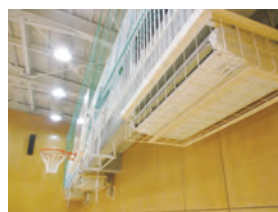
盾津中学校第2体育館に整備されたエアコン
