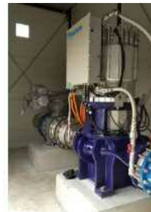
▲ マイクロ水力発電 (水走配水場)
