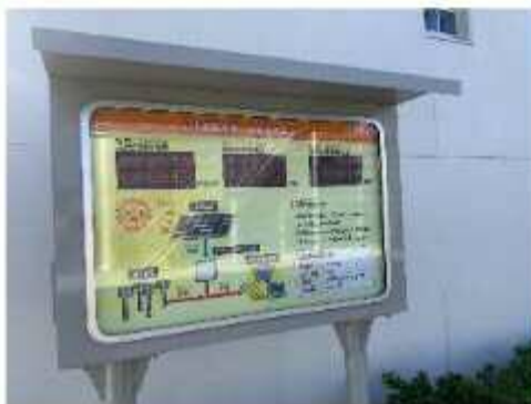
▲ 太陽光発電稼働状況確認 パネル(上小阪配水場)
