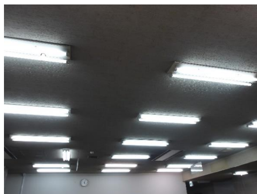
環境への配慮が遅れた設備
