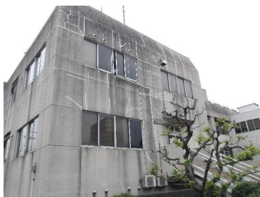
水道庁舎外壁のひび割れ
