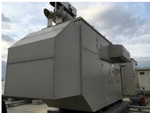
【参考】非常用発電装置
