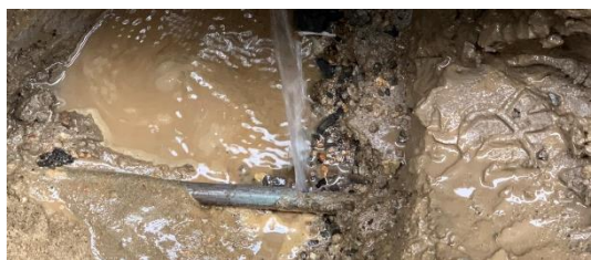
鉛製給水管からの漏水状況
