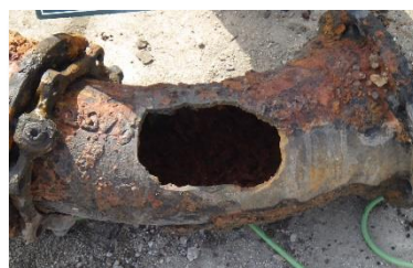
老朽化した水道管
