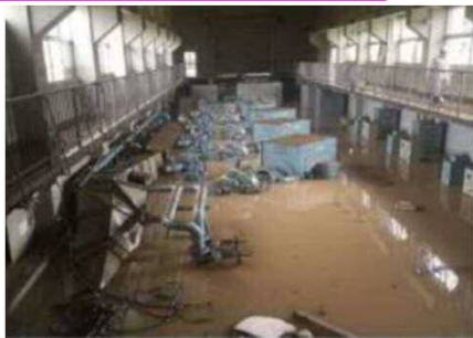
平成30年7月豪雨 取水場の水没被害 (広島県企業局)
