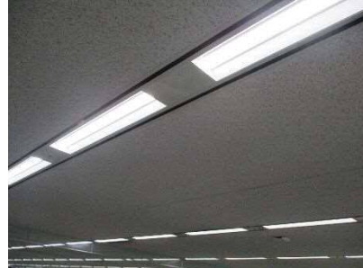
本庁舎の照明LED化
