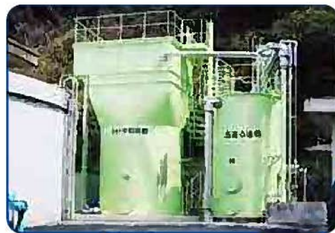
凝集設備と急速ろ過機
