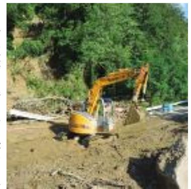
平成25年9月に市内で起こった土砂崩れ
