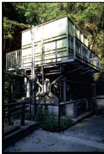
山手町特別高区A配水池
