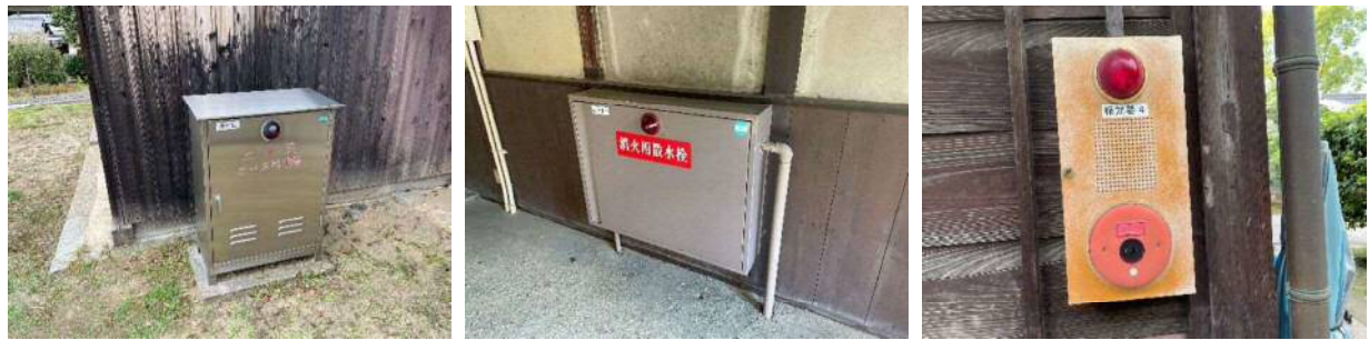
図 4-8 消火関連設備（2021 年 10 月 22 日撮影）
