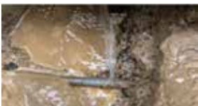
鉛製給水管からの漏水状況
