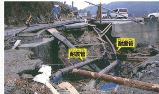
東日本大震災の津波による道路崩壊でも耐震管には被害がありませんでした。
