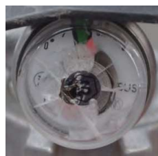
× 指示圧力計の損傷
