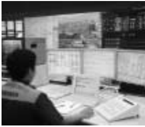
高機能消防指令センターのシステム・指令台
